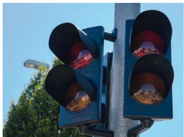
Signalgeber einer modernen LED-Signalanlage
